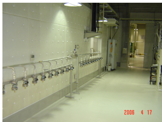
図7 ヘリウム液化・汲み出し室から機械室を臨んだ様子
