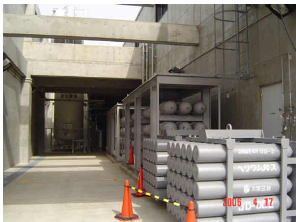
図5 インテックセンター西側から極低温施設内を臨んだ様子
